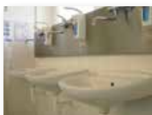
vodovodní baterie a odpady
